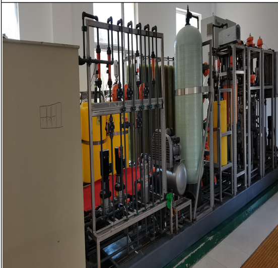
渗滤液处理一体化处理装置
